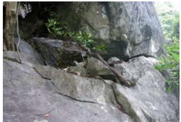
Registro fotográfico de fratura decorrente de evento recente, provavelmente decorrente da operação de lavra
